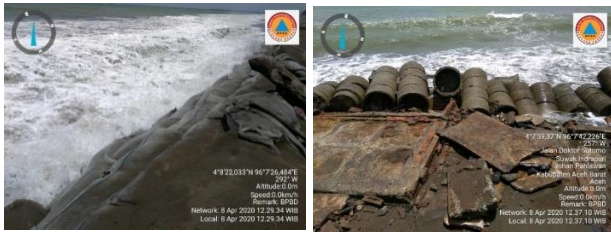
Gambar 3. Kondisi tanggul Geobag dan tanggul cincin sumur
